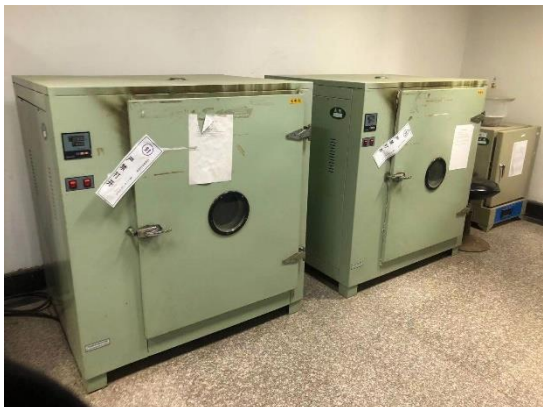
生科楼 3 楼 B 座走廊—2 台大功率干燥箱， 负责人丁艳锋
